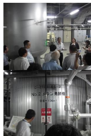
メタン発酵槽
