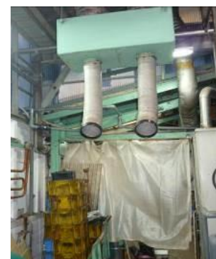
図2 ビニールカーテン
