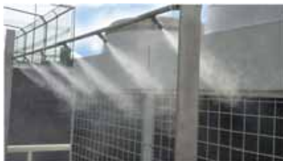
エアコン室外機に噴霧で電力削減
