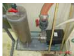
< MFフィルター再生水再利用 >
