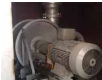
< 集塵機にインバーター設置 >
