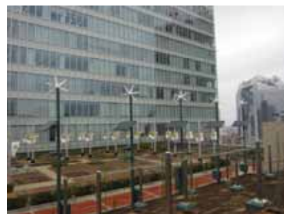
JR大阪駅14階屋上のハイブリッド発電
